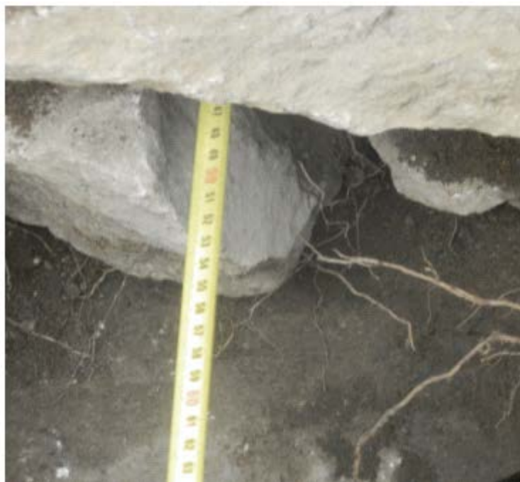
Рис. 6. Разрушения растворной прослойки
