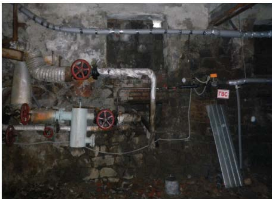
Рис. 2. Протечки атмосферных осадков в подвал через проемы для пропуска коммуникаций.
