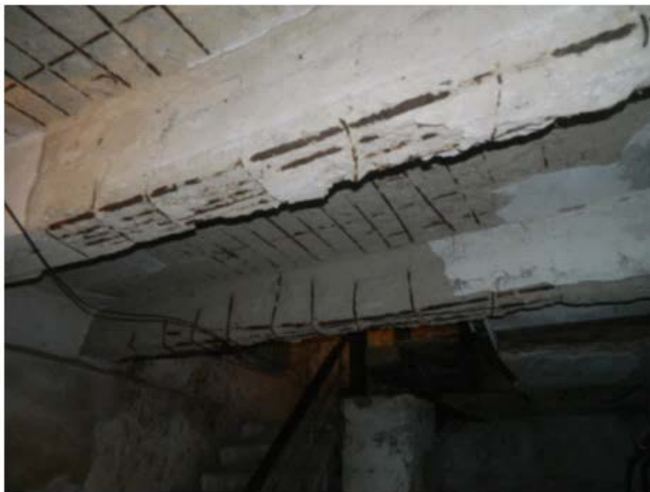
Рис. 3. Разрушение защитного слоя бетона балок и плит перекрытия. Оголение и расслаивающая коррозия стержней рабочей арматуры
