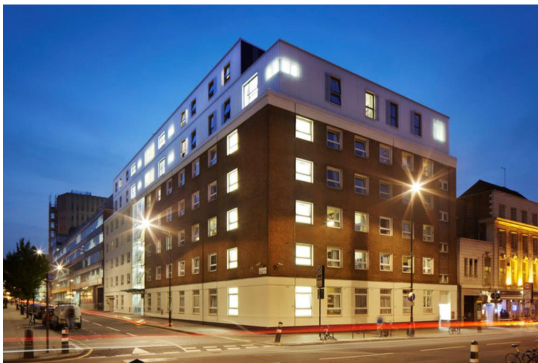
Рис. 16. Реконструкция здания 50-ых годов с применением блок-модулей для надстройки двух верхних этажей. Лондон, Англия.
