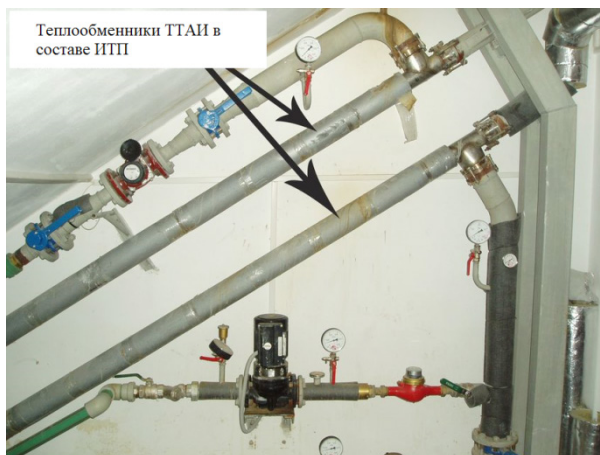
Рис. 4. ИТП (блок ГВС) размещен под лестничным пролетом
